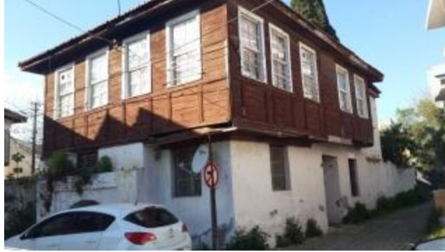
Resim 12: Cephe Boyunca Mevcut Çıkma Örneği
